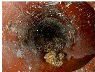
Tukové hrdky v kanalizačním potrubí
